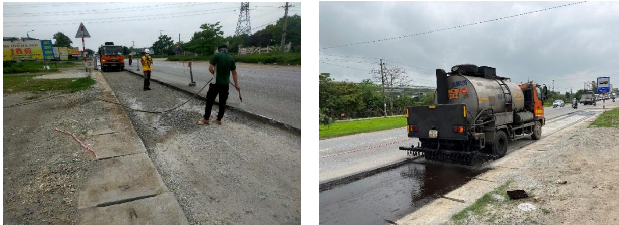
Hình 4. Công tác chuẩn bị mặt bằng và tưới vật liệu thấm bảm tại hiện trường
