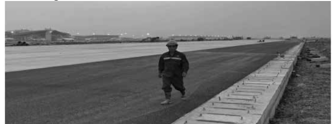
Hình 5. Hình ảnh cải tạo rãnh thoát nước tại CHK quốc tế Nội Bài [4]
