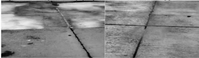
Hình 2. Tấm BTXM hư hỏng khu vực đường lằn NS tại CHK quốc tế Tân Sơn Nhất [3]
