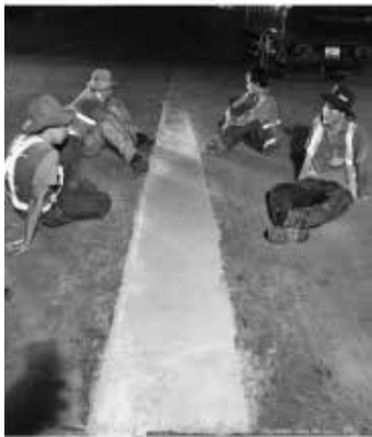
Hình 13. Đổ vữa và thi công Rigid Ground Structural HT vào vị trí trám vá [1]
