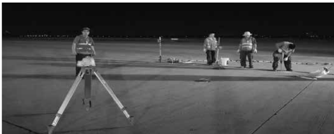
Hình 7. Khoan tạo lỗ bơm vữa Uretek để gia cố nền móng mặt đường cứng sân bay [1]
