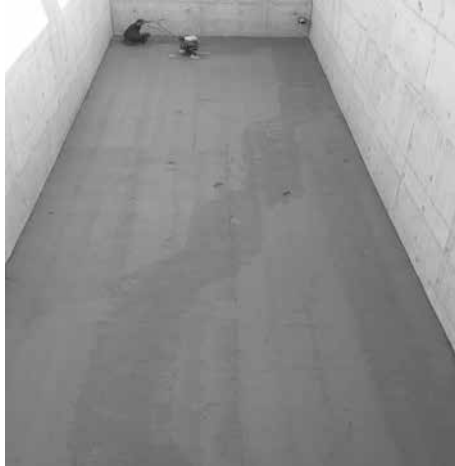
Hình 3. Đơn vị thi công bê lắng sai cao độ chuẩn bùn lắng không tự chảy về hồ thu - phải bổ sung độ dốc
