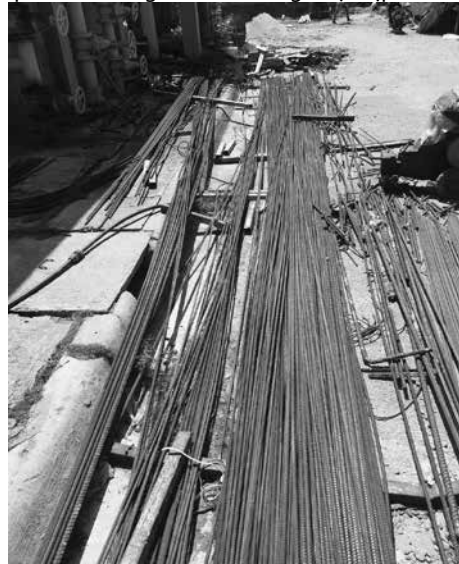
Hình 2. Công tác bảo quản thép không đúng yêu cầu kỹ thuật tại công trường 2.2.3. Thực trạng công tác kiểm tra, giám sát của nhà thầu tư vấn và của chủ đầu tư
